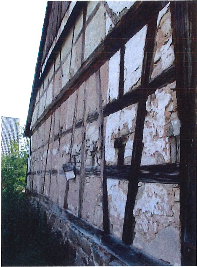
Ostseite: Starke Putzschäden, ausknickender Sockel
