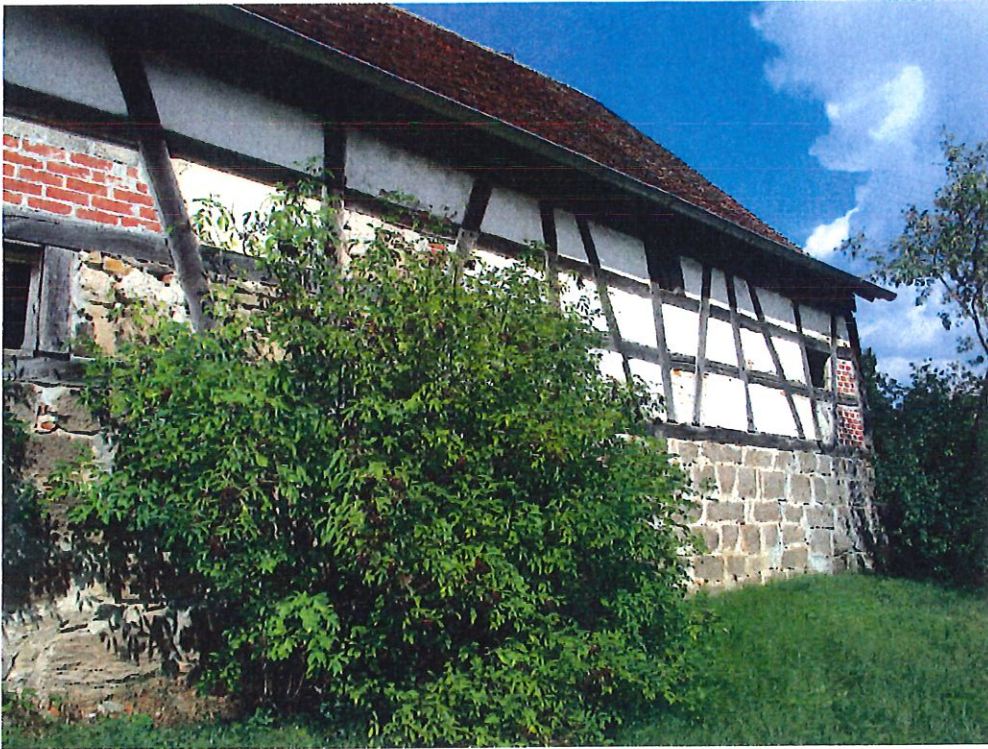
Scheune Südseite stark verformter Sockel
