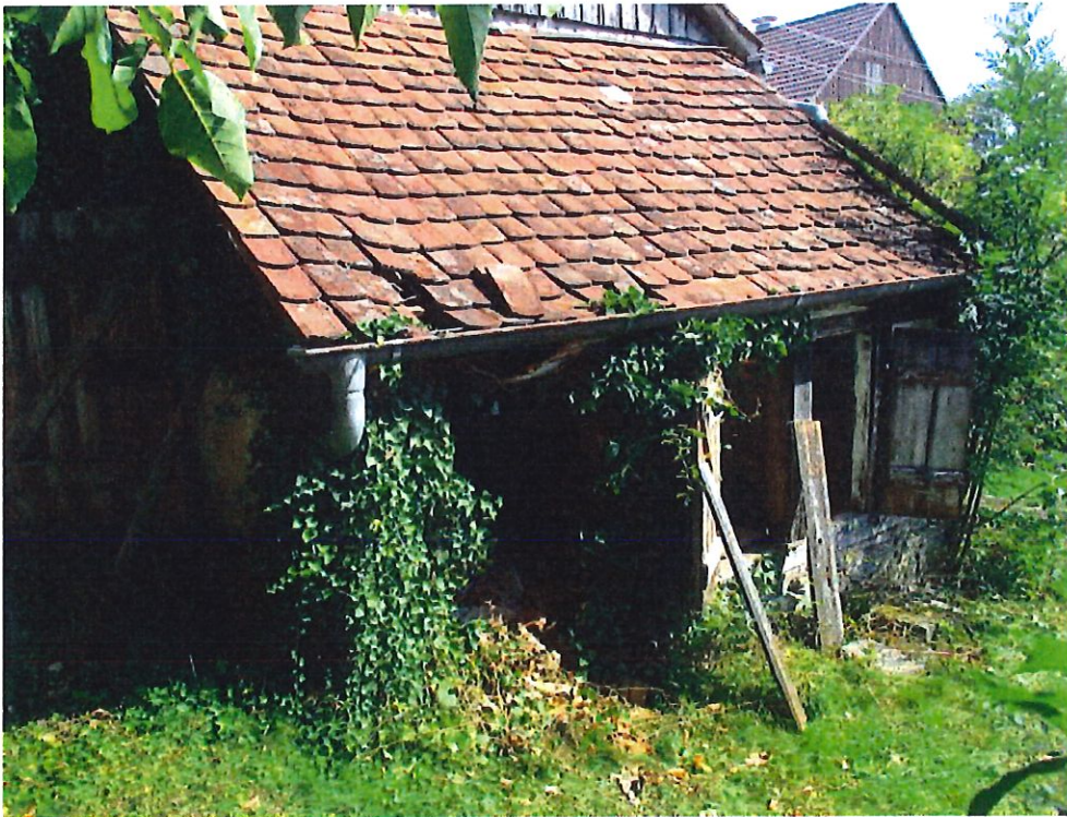
Anbau auf der Westseite baufällig
