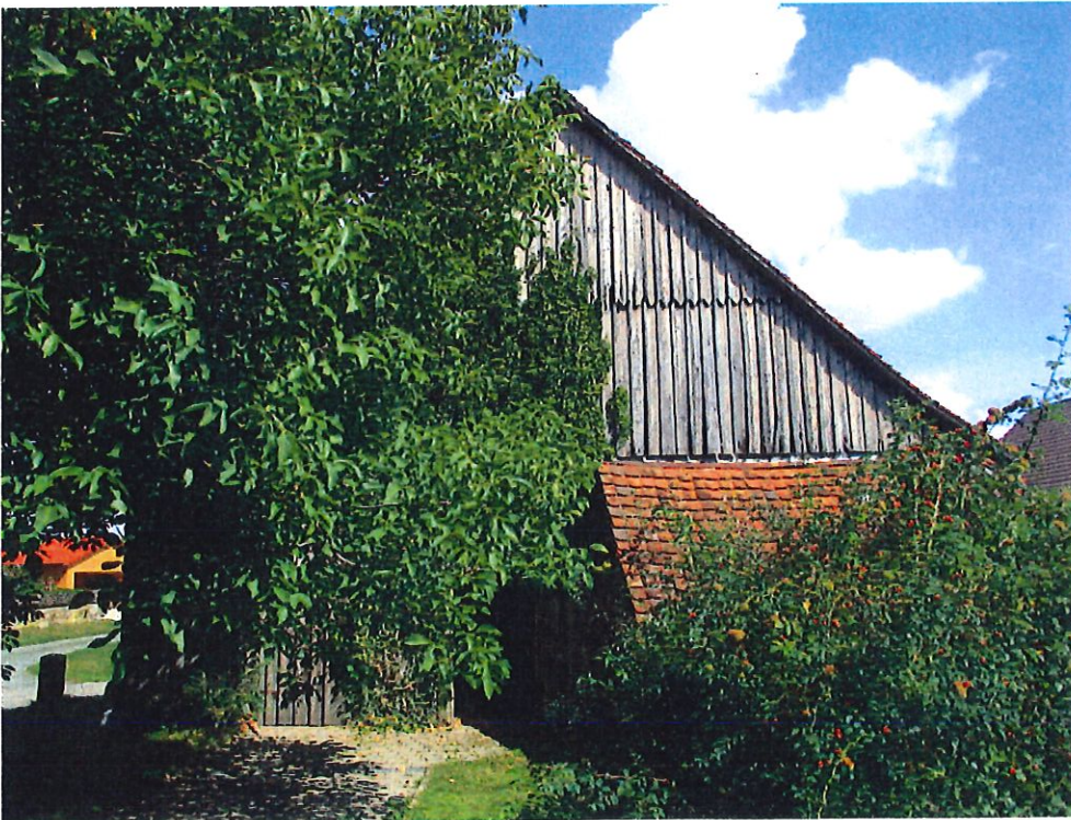
Scheune Westseite Teilweise abgängige Bretter in der Giebelverschalung
